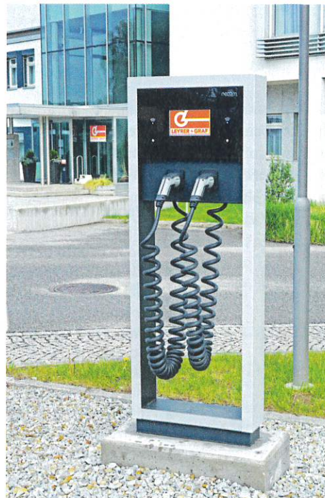
An den Standorten von Leyrer + Graf werden laufend E-Ladestationen installiert. Allein heuer werden 600.000 Euro in E-Mobilität investiert.
